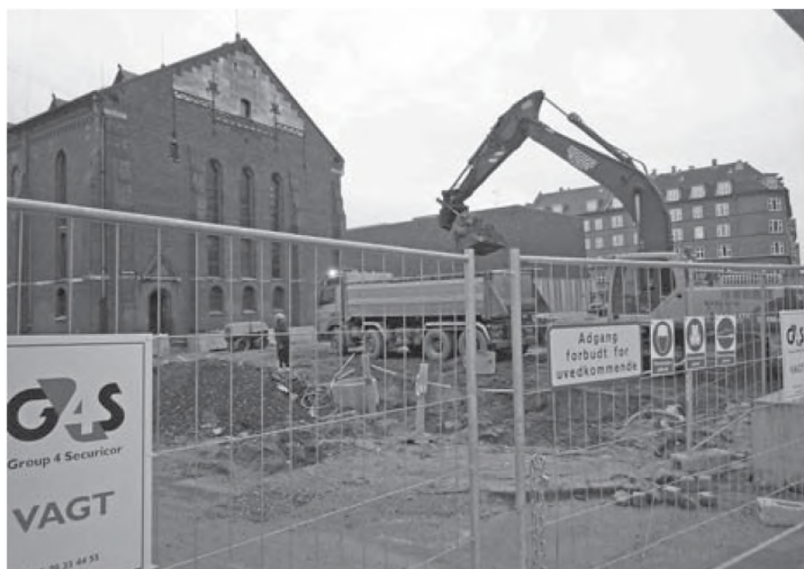
Fig. 23: Metroselskabet er ved at etablere en ny station lige ved siden af Landsarkivets bygninger. Ved en sjælden grad af timing begyndte det støjende gravearbejde samme uge, som arkivets læsesal blev lukket. Det tidsmæssige sammenfald var imidlertid en tilfældighed. For ifølge den oprindelige plan skulle gravemaskinerne have været i gang ni måneder tidligere. Foto: Jørgen Mikkelsen 2011.
